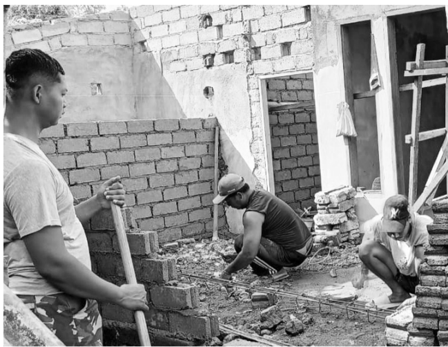
PEMBANGUNAN - Program TMMD ke-128 melaksanakan pembangunan Rumah Tidak Layak Huni (RTLH), Selasa (28/4/2026).
